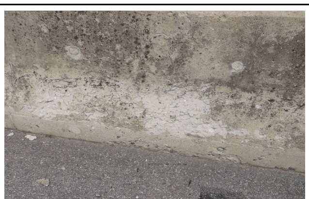
방호벽 하단 콘크리트 열화(S1)
